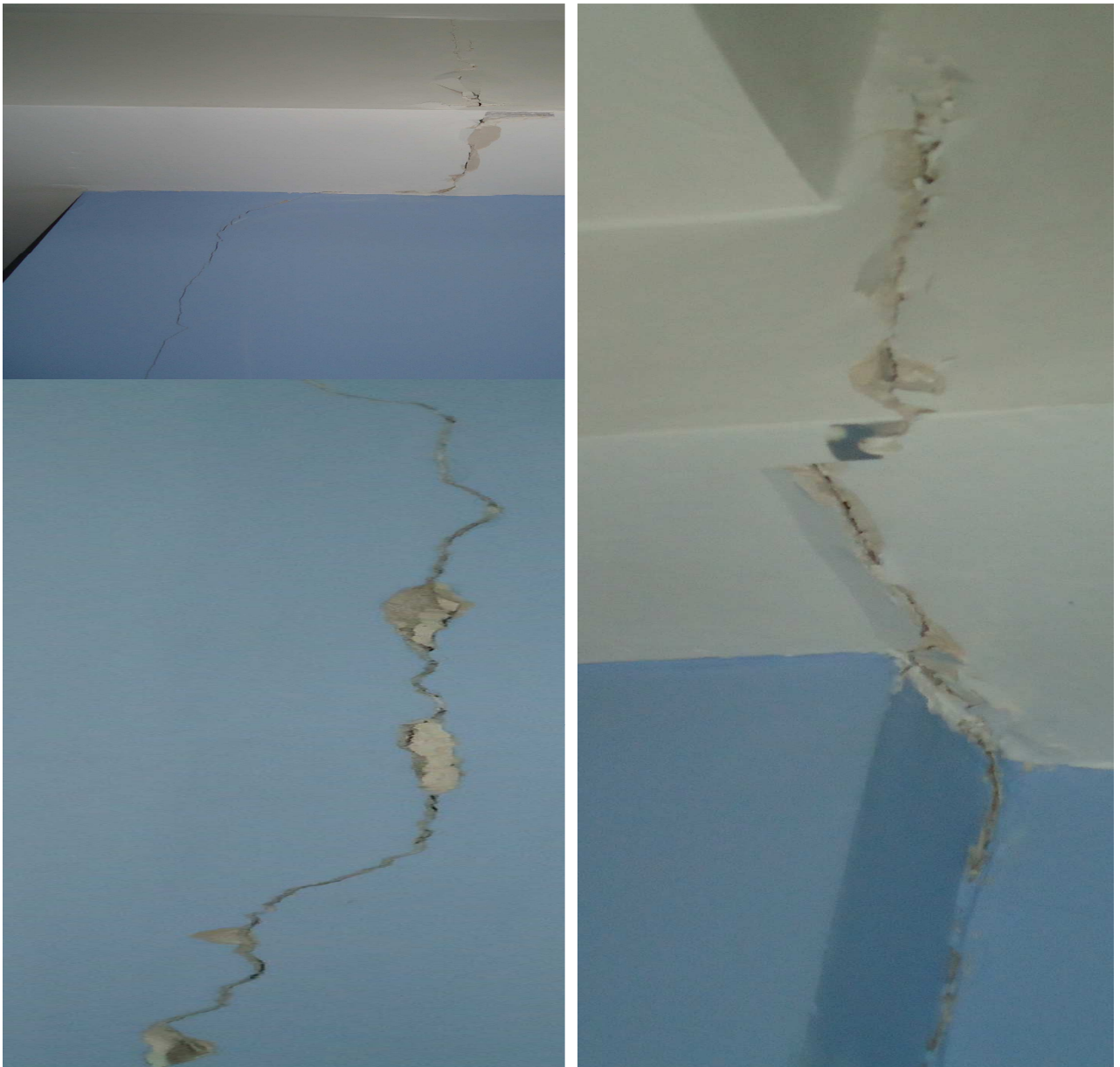
а) фрагмент стеновой трещины второго этажа б) фрагмент трещины третьего этажа
