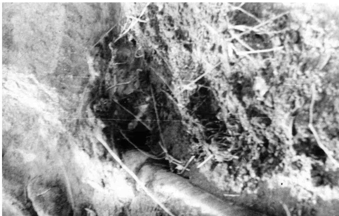
Рис. 26. Суффозионная воронка у водовода АО «Барнаулский меланжевый комбинат» на Обском склоне
