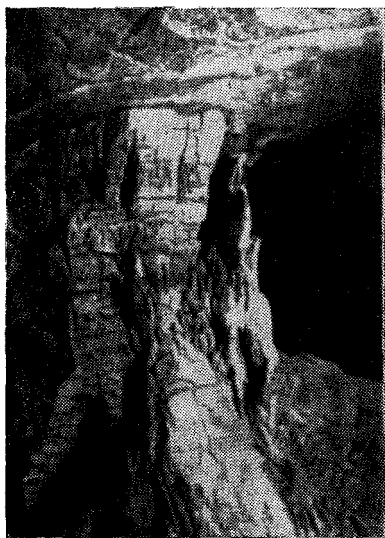
Рис. 22. Характер разрушения целика каменной соли (Южный Гарц [169]).
