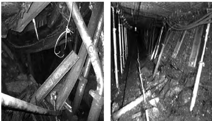
Рис. 13.1. Вид горных выработок после горного удара (шахта Дааньшан, Китай)
