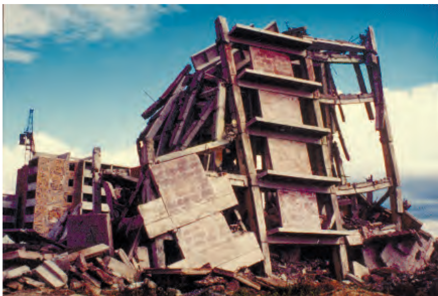
Рис. 2.1. Разрушение зданий, вызванное сейсмическими колебаниями (фото Г. Тидеманн)
